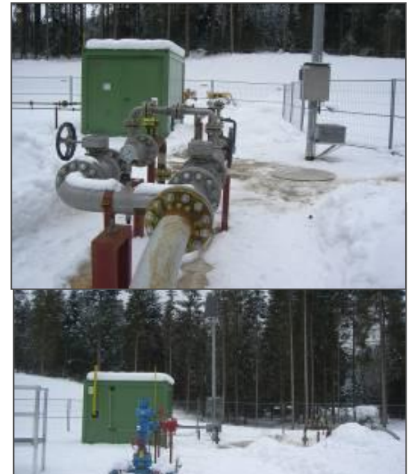
Контрольно-измерительные пункты для удаленного мониторинга и управления процессами
